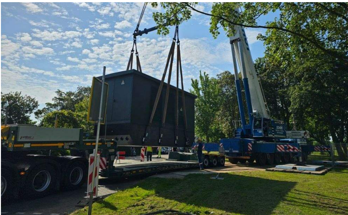
Het Liander programma Netuitbreiding Lelie (afgekort als NuLelie) is een samenvoeging van vele projecten. We leggen ruim 3.000 kilometer aan stroomkabels en plaatsen of vernieuwen ruim 400 elektriciteitshuisjes.
